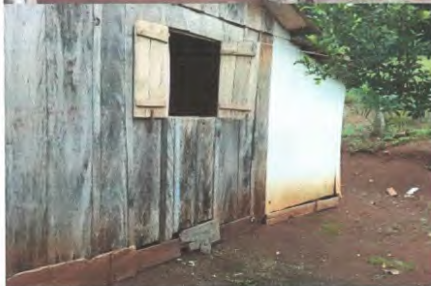
O Módulo será construído atrás da casa com elevação de estrutura (pessoa idosa)
